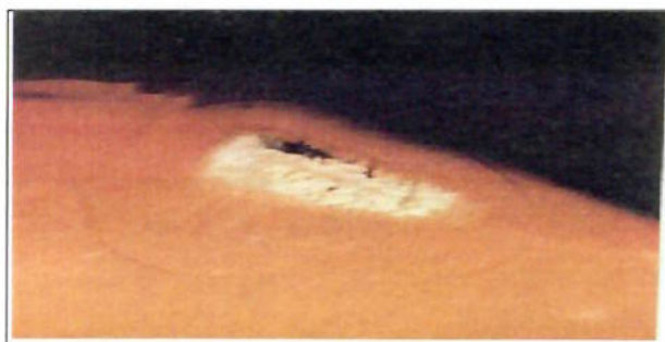
FIGURA 13– Abrasão nível 2 (reparo e teste hidrostático são necessários)
