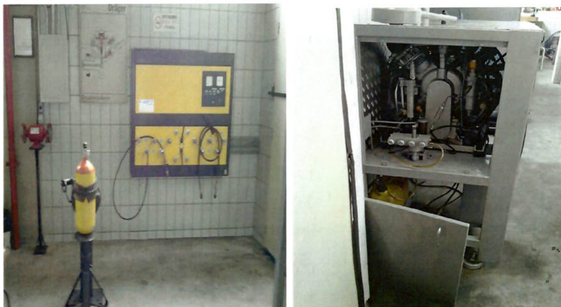
FIGURA 22 - Equipamento fixo de recarga de cilindro e compressor de ar.
